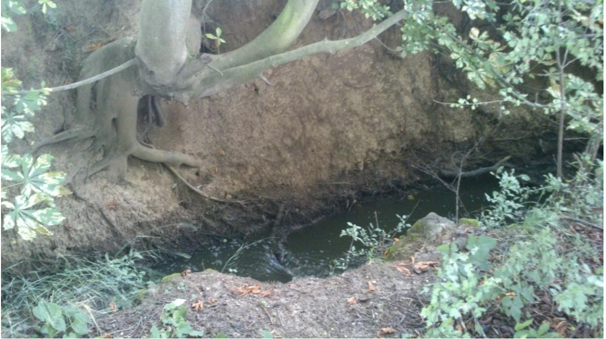
Zdjęcie nr 1 – Rów „A”, km 1+050
