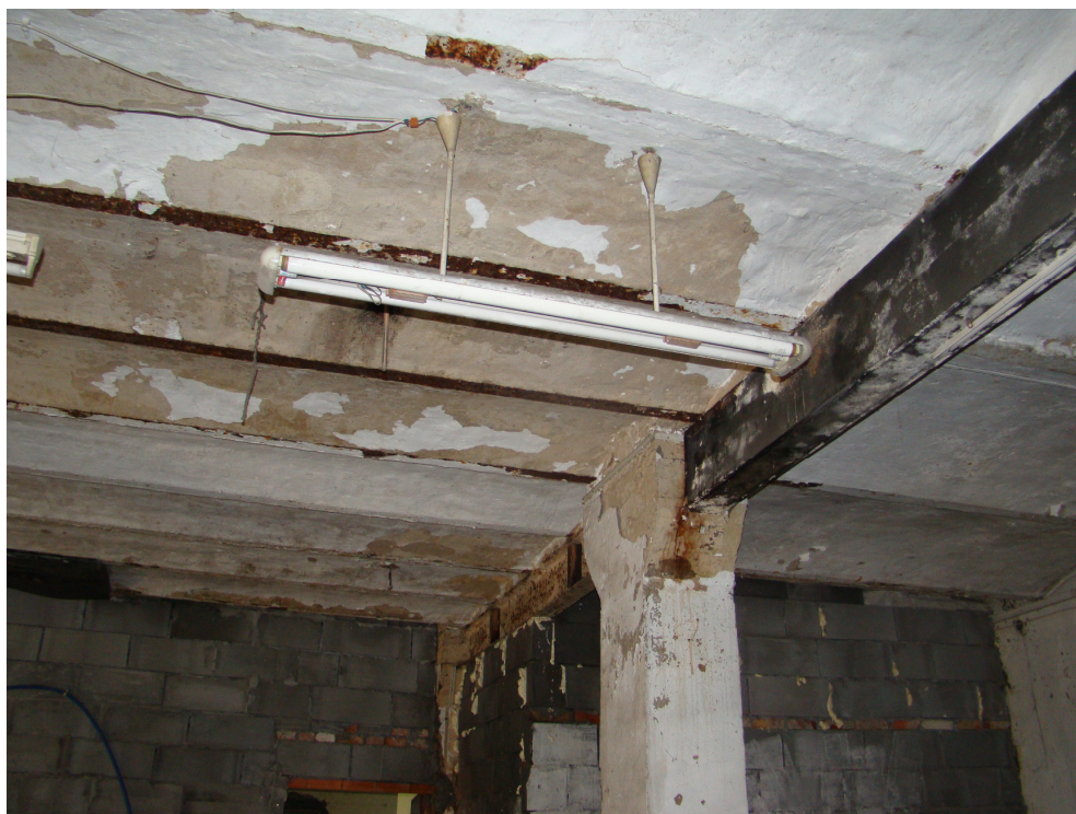
Fot.. Nr10 Parter. Skorodowane belki stropowe i podciagi.
