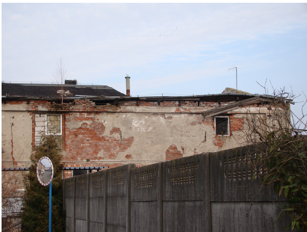
Fot. Nr5 Elewacja tylna. Zawalony stropodach.
