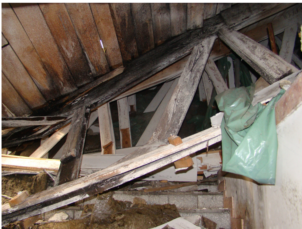
Fot. Nr7 Piętro. Zawalone dźwigary w rejonie klatki schodowej.
