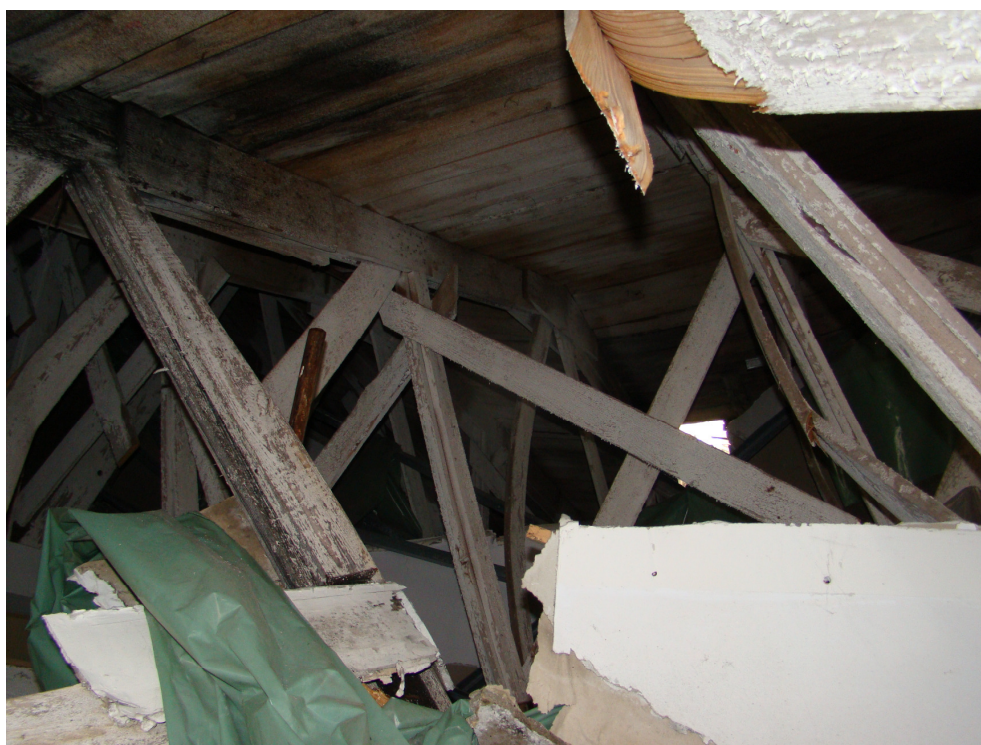
Fot. Nr8 Piętro. Zawalone dźwigary w rejonie klatki schodowej.
