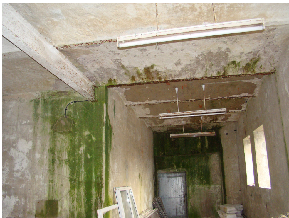
Fot. Nr9 Parter. Skorodowane belki stalowe, glony na ścianach pod rejonem zawaliska.
