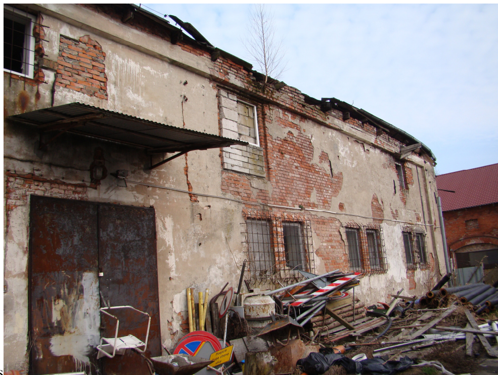
Fot. Nr6 Elewacja tylna. Widok ściany w miejscu zawalonego stropodachu .
