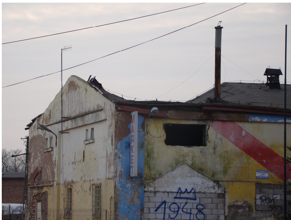
Fot. Nr4 Elewacja frontowa. Zawalony stropodach.
