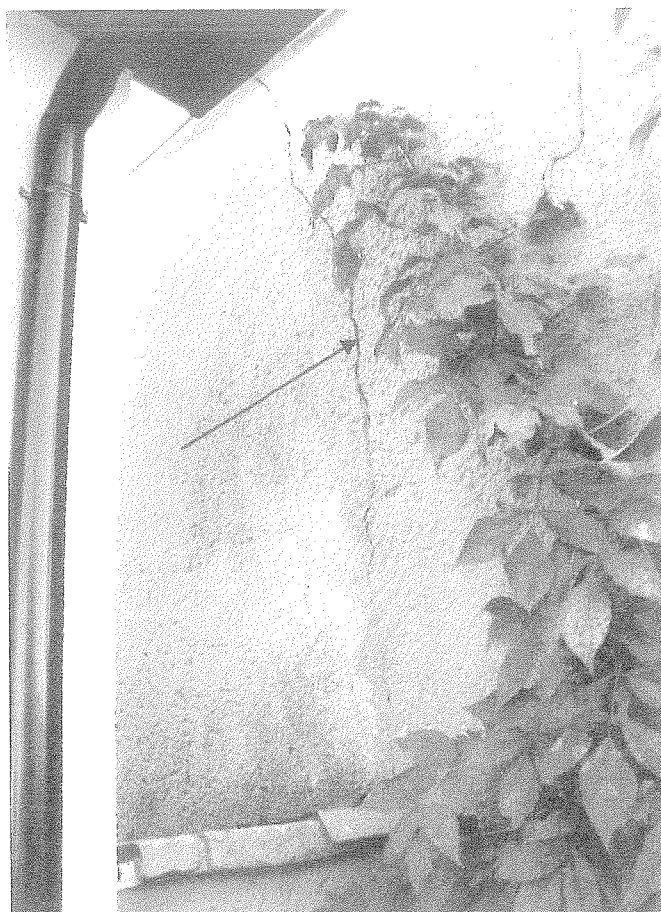
FOT. 6 Pęknięcie ściany podłużnej północnej.
