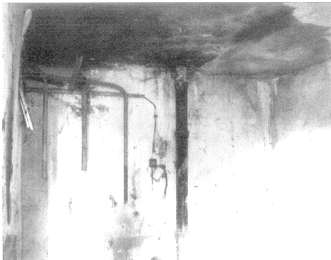
FOT. 22 Kociołnia. Widoczne zacieki na stropodachu i ślad sadzy.
