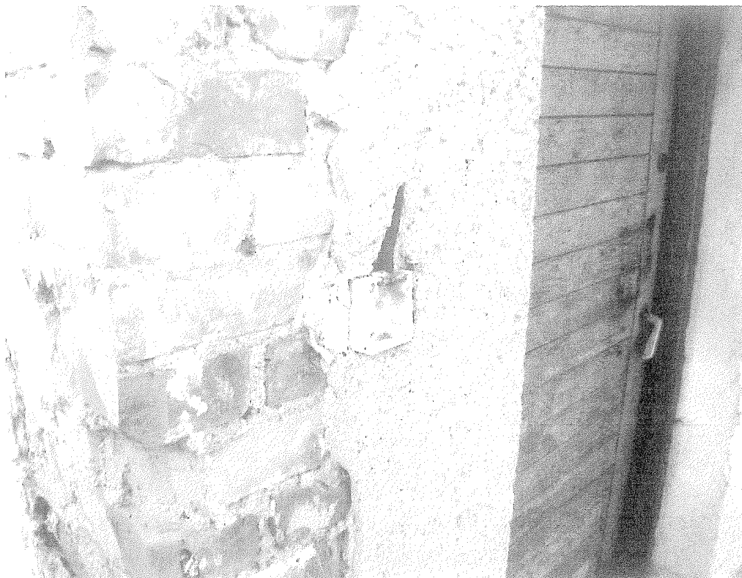
FOT. 16 Wieża. Ubytki tynku.
