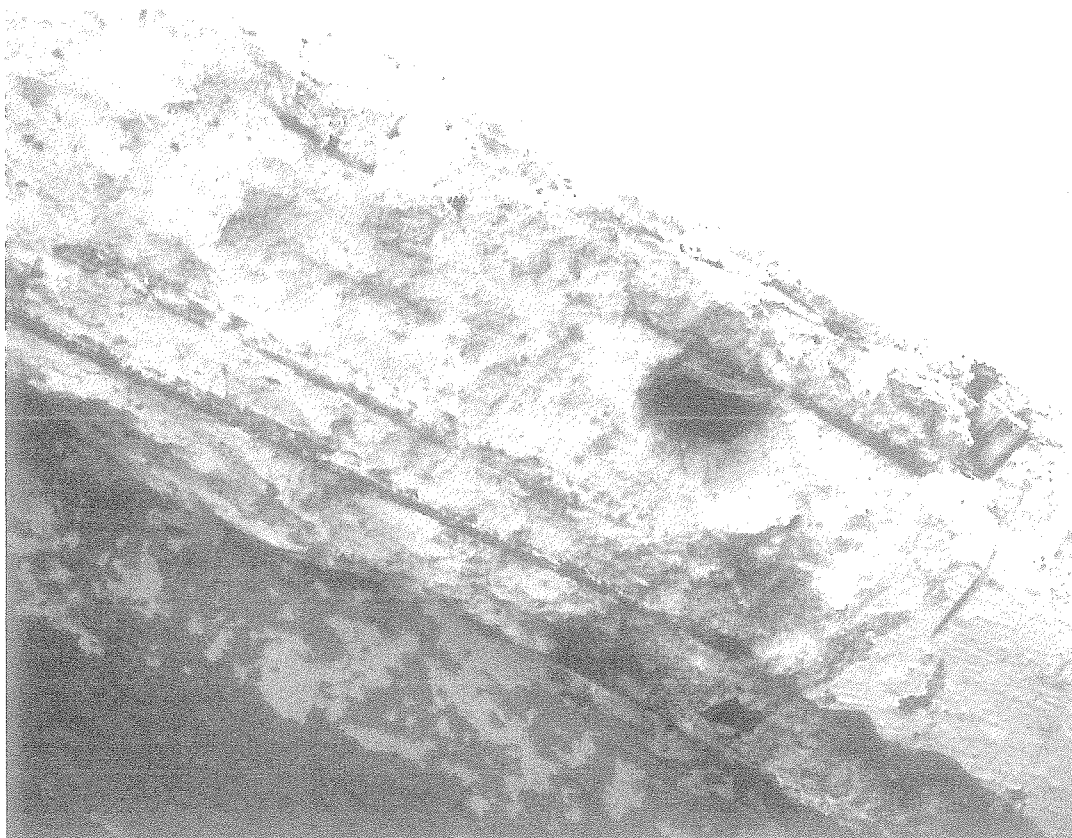
FOT. 13 Uszkodzenia nadproża bramy wjazdowej w ścianie frontowej.
