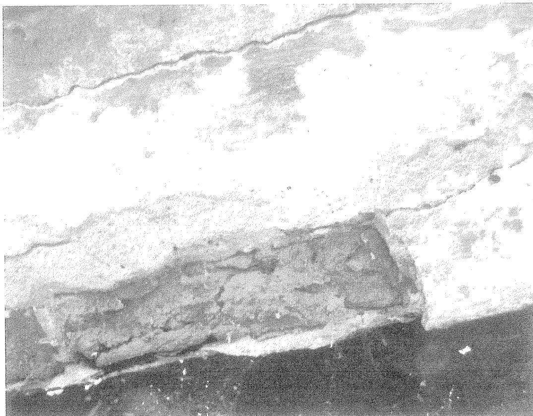
FOT. 20 Nadproże drzwi zewnętrznych do kotłowni. Widoczne skorodowanie cegieł.
