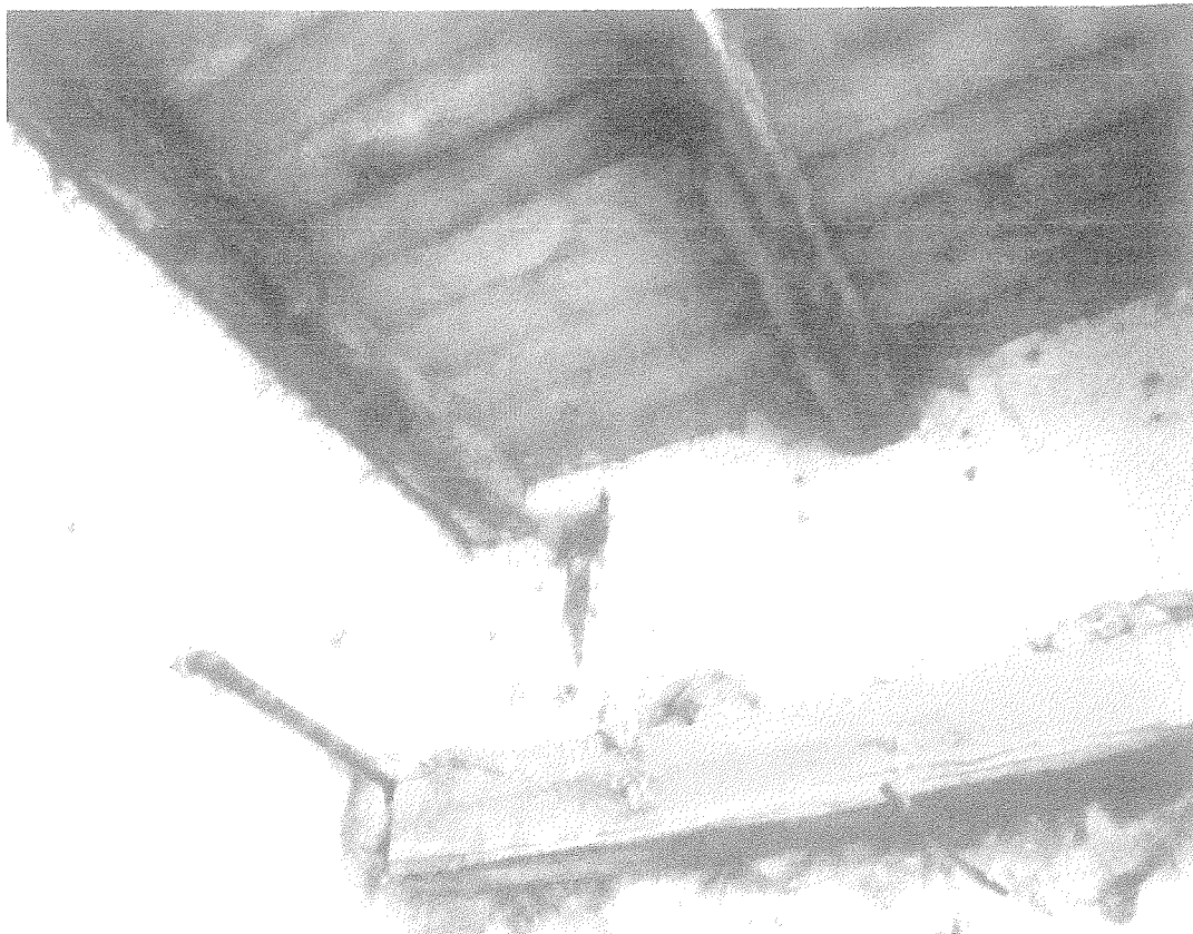
FOT. 19 Wieża. Strop na poziomie pierwszym. Widoczne zacieki.
