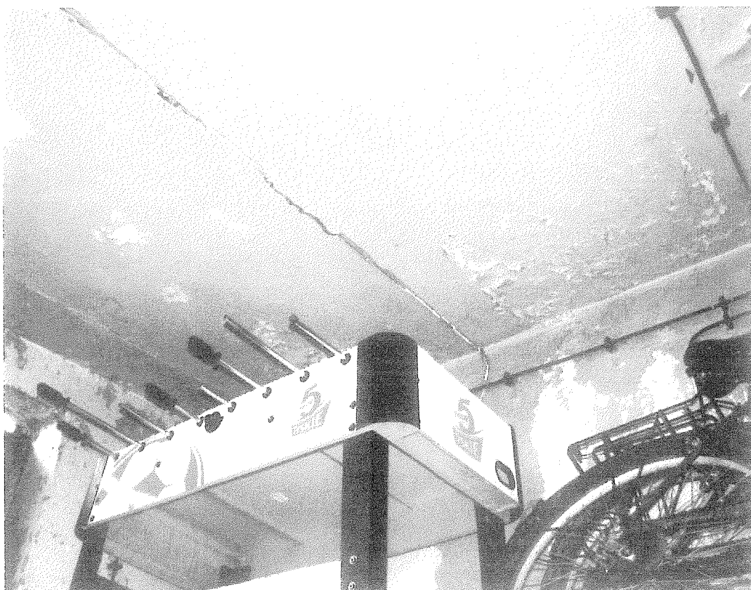
FOT. 10 Pęknięcie stropu.
