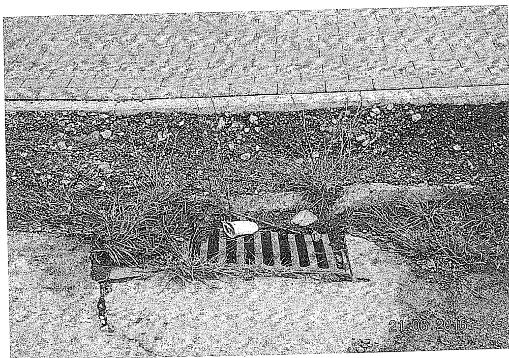
Fot. 3 Kratka ściekowa na zamulonej studzience
