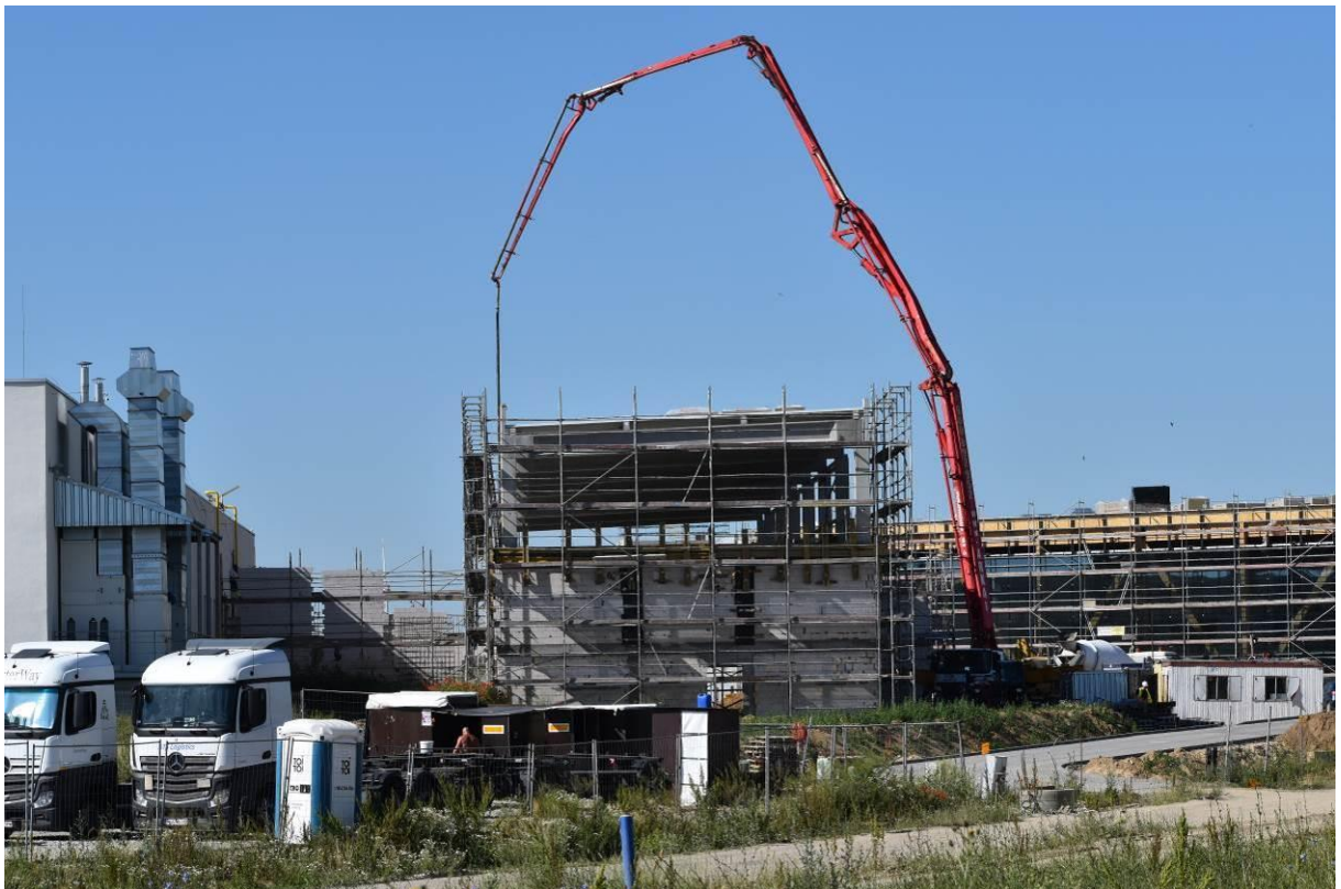
Fot. Realizowane budynki na działkach: lewy – rozbudowa zakładu PMC na działce nr 114/35, prawy – realizowany budynek na działce nr 114/45.
